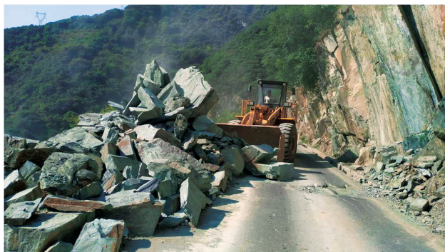
2019年9月26日,西安公路管理局在108国道山区段清理塌方 (西安公路管理局 蔡鹏辉)
