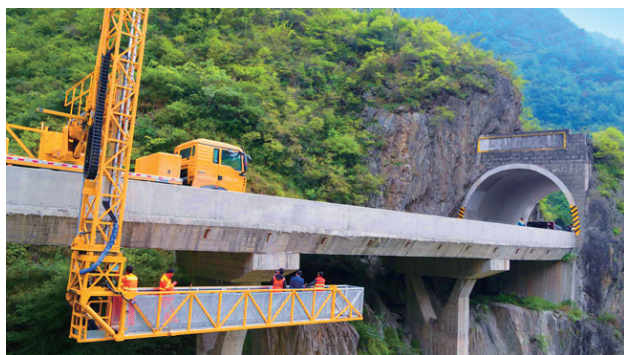
2019 年 10 月，汉中开展独柱墩式桥梁安全隐患专项排查（汉中市公路局）
